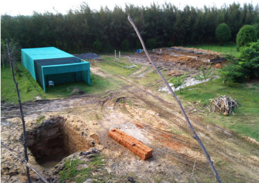
Groentekas, put afvalwatertank en bouwplaats veestal.
